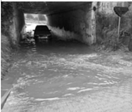
Vytrvalý dážď robí pravidelne problémy so zatápaním podjazdu pod železnicou v Púchove.
