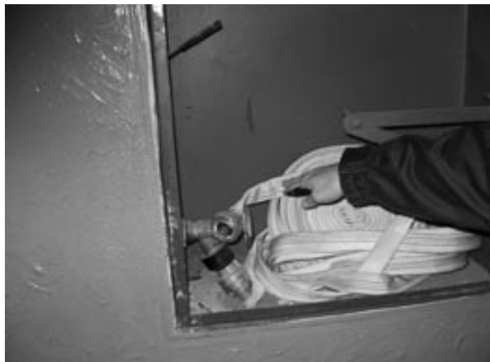
Tento hydrant je v prípade požiaru nepoužiteľný - chyba mu základné vybavenie - prúdnica.
